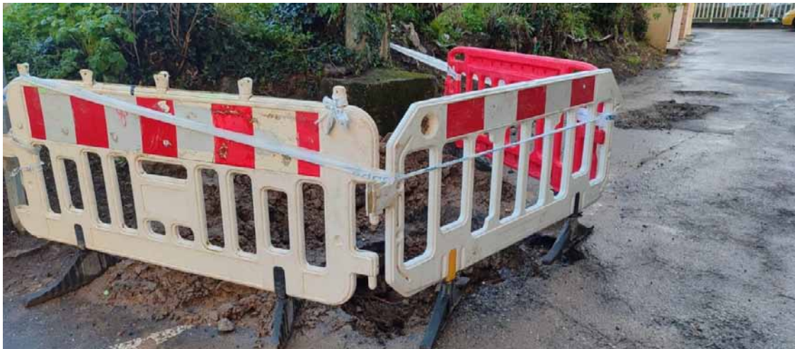
Vecinos del barrio vigués de Teis denuncian roturas en una tubería de agua desde hace más de 10 añosA.V. DE TEIS
