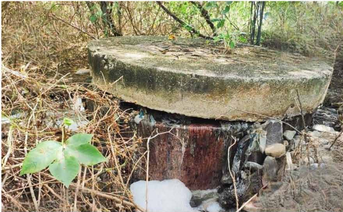
Este es uno de los manjoles, que cuando se rebosa vierte agua residual y este mal olor afecta a los habitantes.
