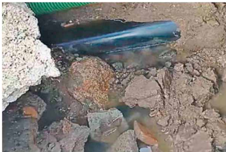
Hundimiento del asfalto frente al bar Casa Barbeiro de Aldán esta semana.
